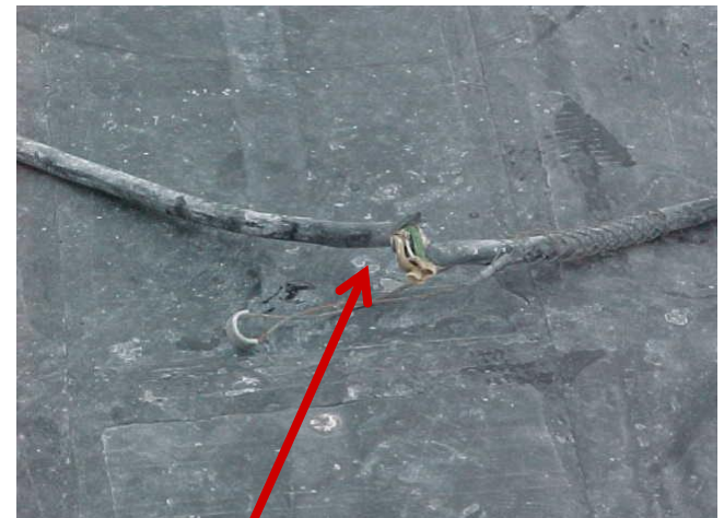
Cable dañado removido del servicio
